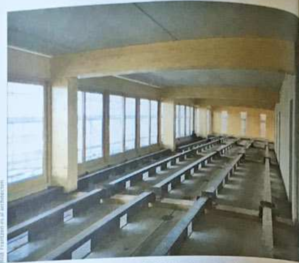
Eher ungewöhnlich ist das Deckentragwerk. Die Betonelemente sind lediglich 7 cm dick. Zusammen mit einbetonierten IPE-Stahlträger bieten sie Tragsicherheit, Brandschutz und Schallschutz und später den Hohlraum für die Installationsführung.
