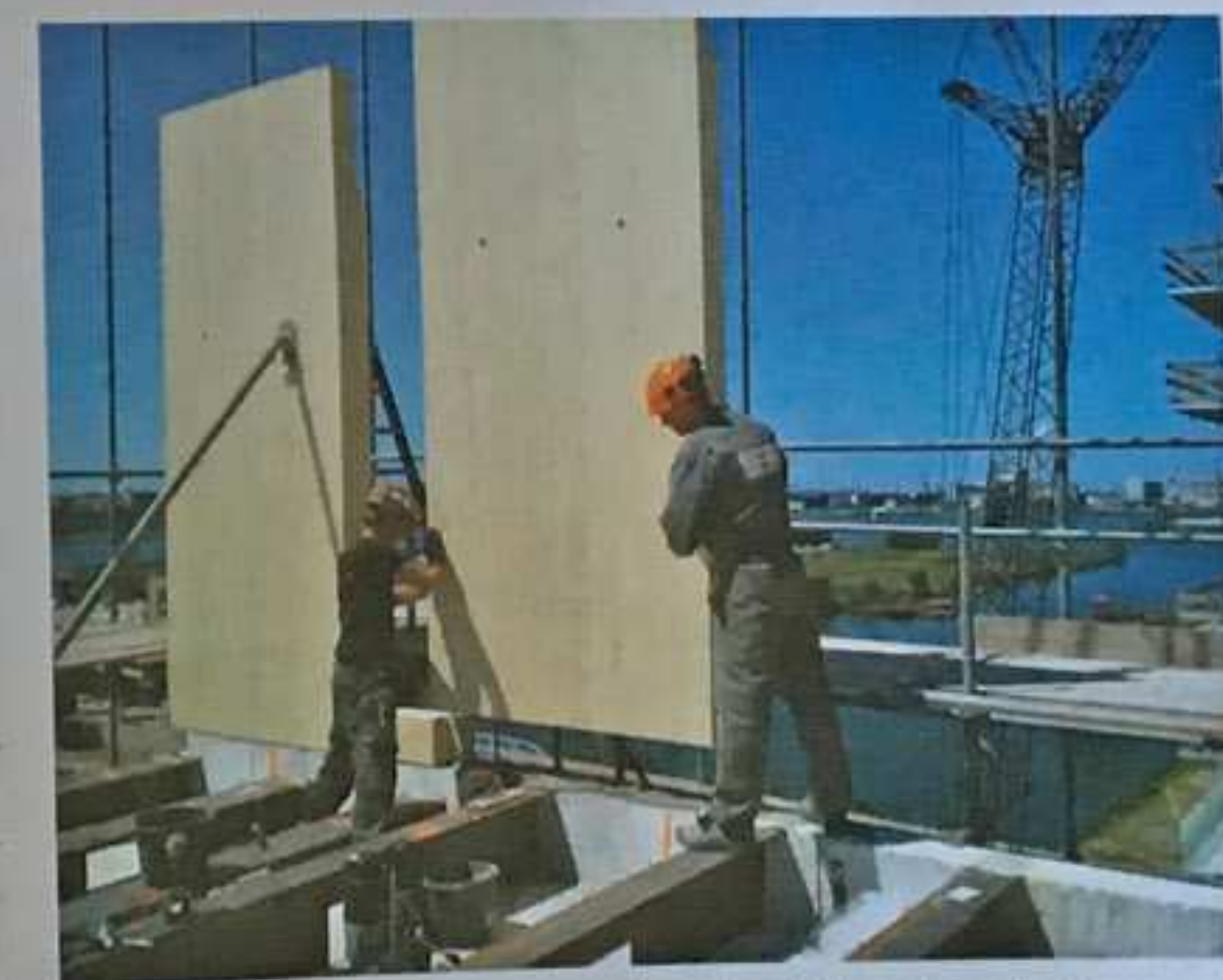
Ab dem ersten Obergeschoss kommen in dem Hochhaus hölzerne Außenwände zum Einsatz.
